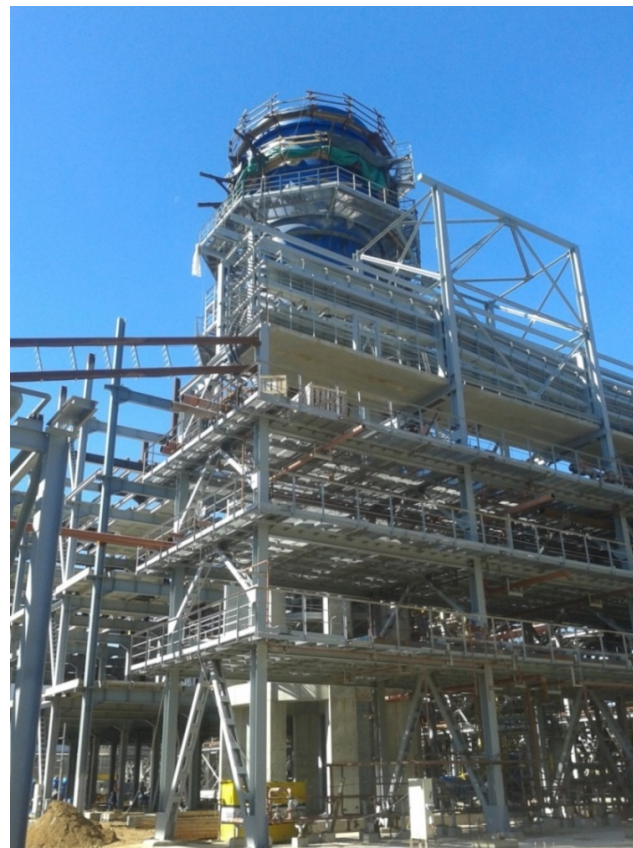
ООО «Лукойл-Волгограднефтепереработка» установка ЭЛОУ-АВТ
