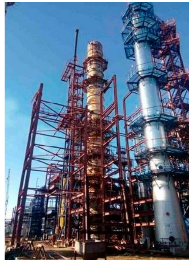
ПАО «Орскнефтеоргсинтез» установка гидрокрекинг
